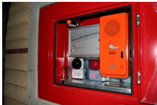
Wandkästen für die Feuerwehr an den Tunnel Ein- und Ausgängen
